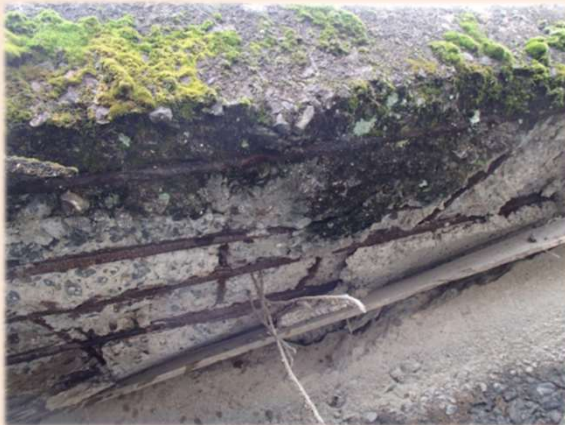
床版部の鉄筋露出
