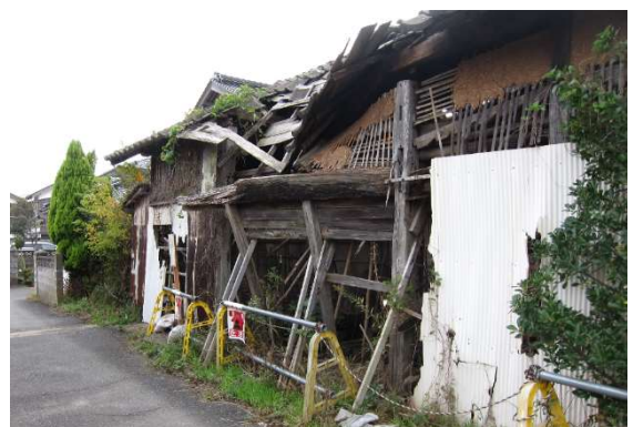
周辺に迷惑・危険が及ぶ可能性がある 「特定空家等」の事例写真
