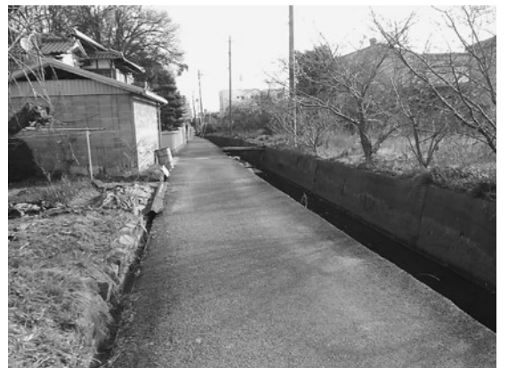
転落事故のあった用水路
