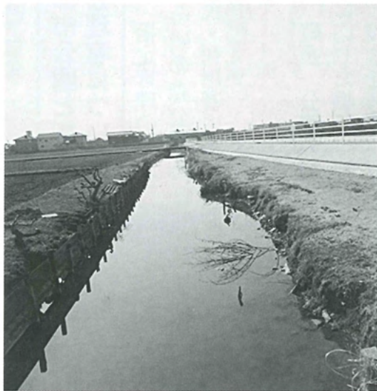
町道1号線の緑地帯の護岸状況
