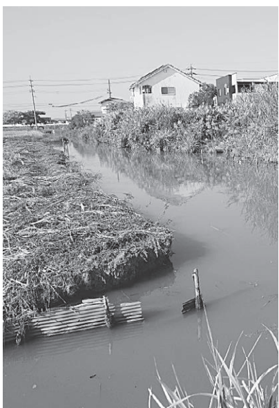
老朽化著しい水路の早急な改修を
