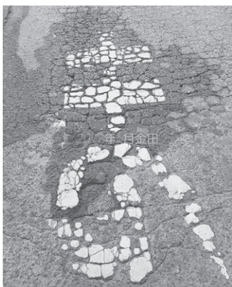
道路損傷箇所の早急な改善を
