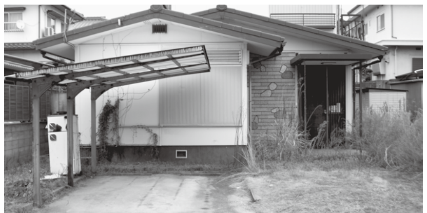
荒れ放題、放置された空き家
