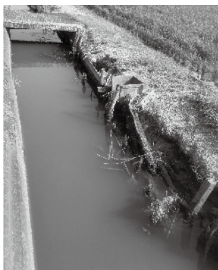
崩落箇所も多数ある JR 線南の水路農地の基盤整備が求められる
