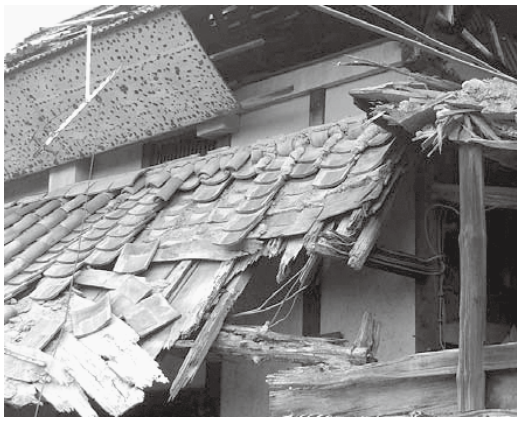
倒壊などの危険性の高い「特定空家」の対応が急がれる
