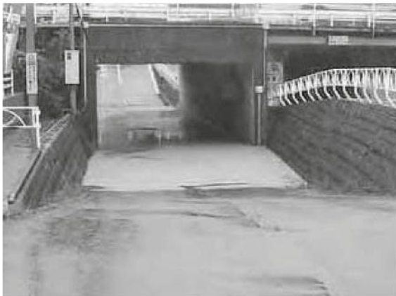
大雨による2号線隧道の浸水
