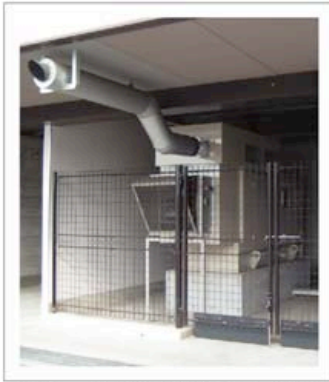
↑庁舎・小学校に整備された非常用発電施設
