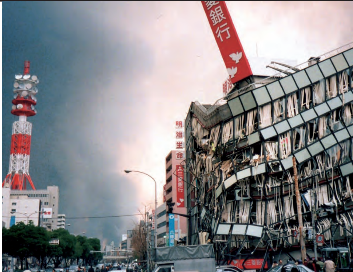
▲写真は神戸市提供-兵庫区水木通1丁目
