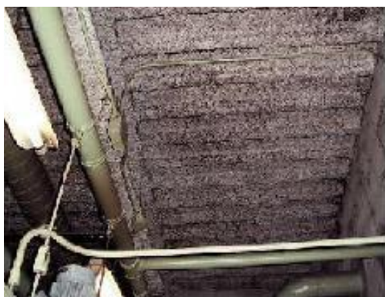
石綿含有吹付けロックウール
